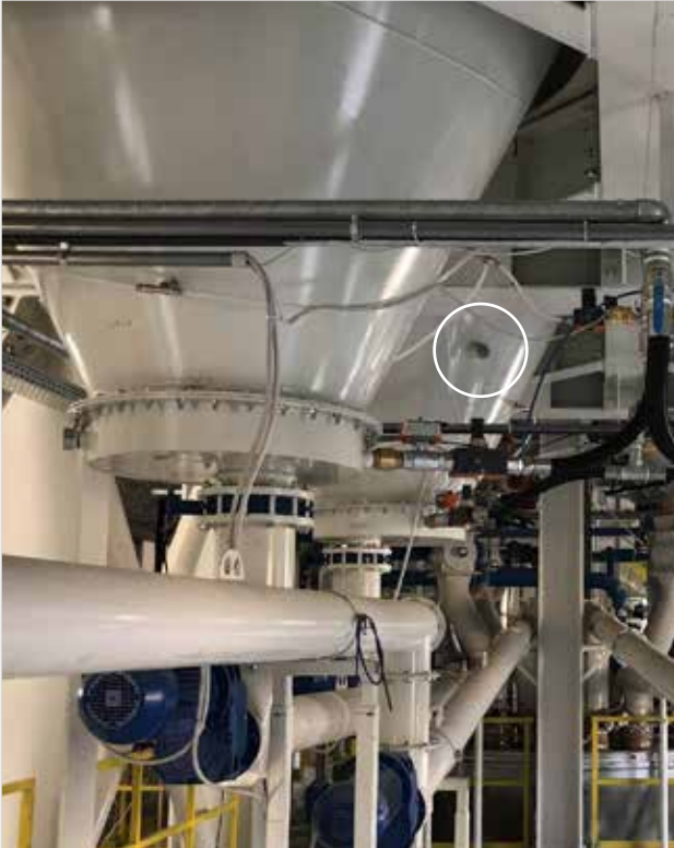
VBS [aerador] - Silos
