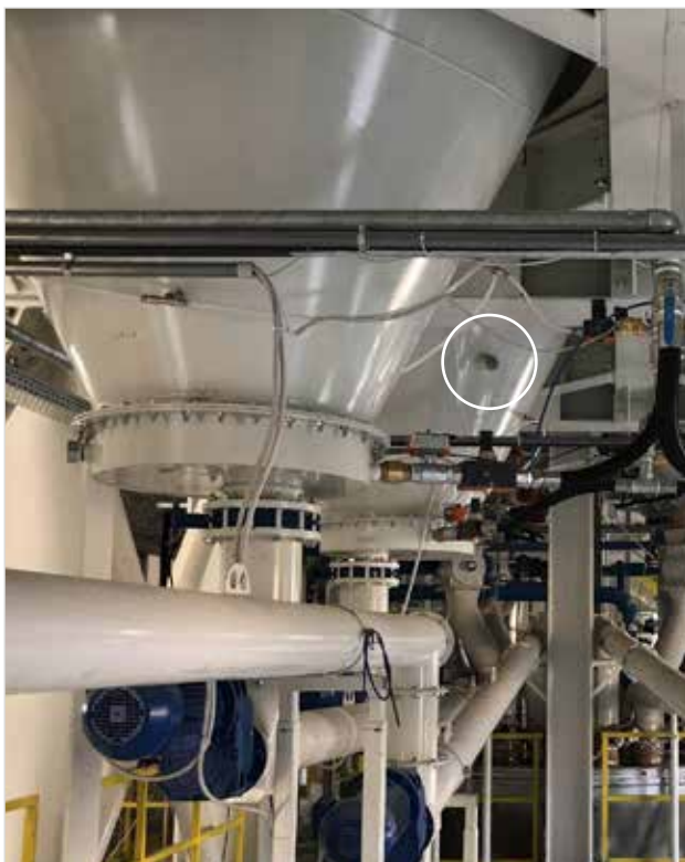
VBS (аэраторы) - Силос
